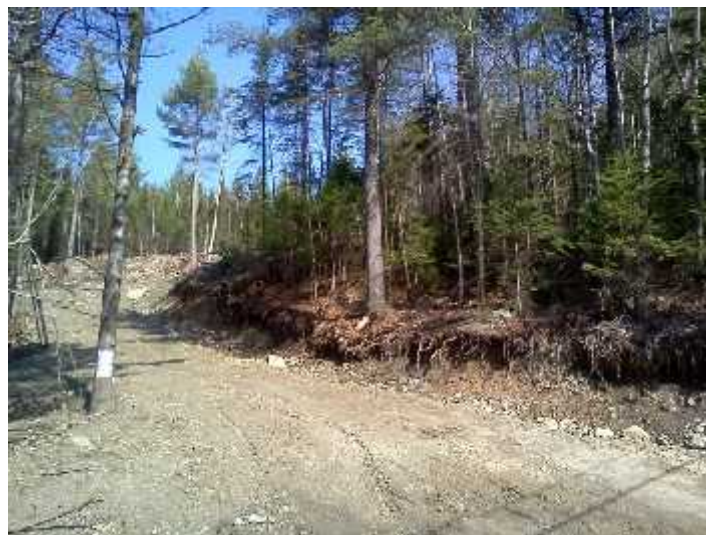
Figure 3 : Chemin Brême - Absence de mesures de prévention pour contrôler l'érosion
